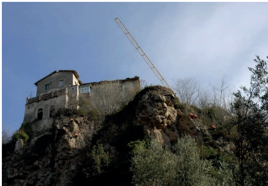
Fig. 48 - Pale, la parete di travertino destabilizzata dalle scosse sismiche del 1997 (autore Fiorella Patarini).
